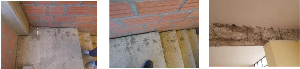
Figura 3. Desplazamiento y desprendimiento del hormigón
