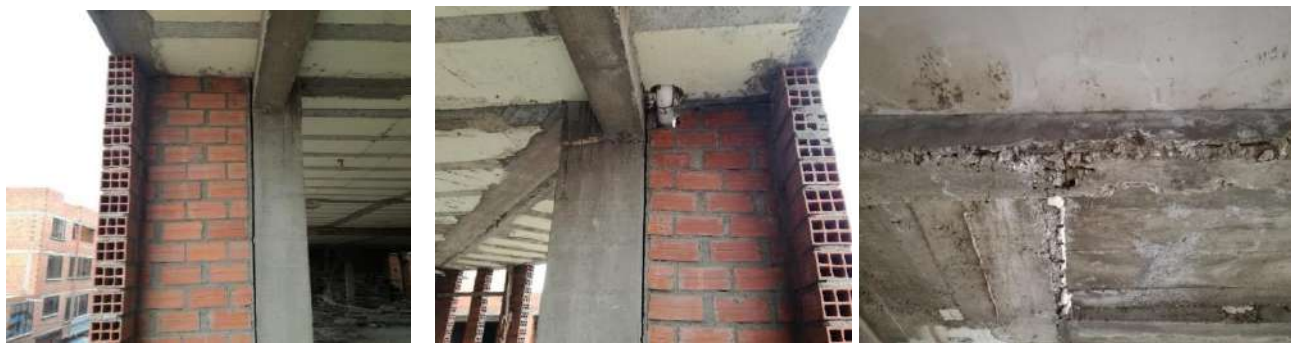
Figura 7. Separación vertical entre tabiquería y columna (volados)
