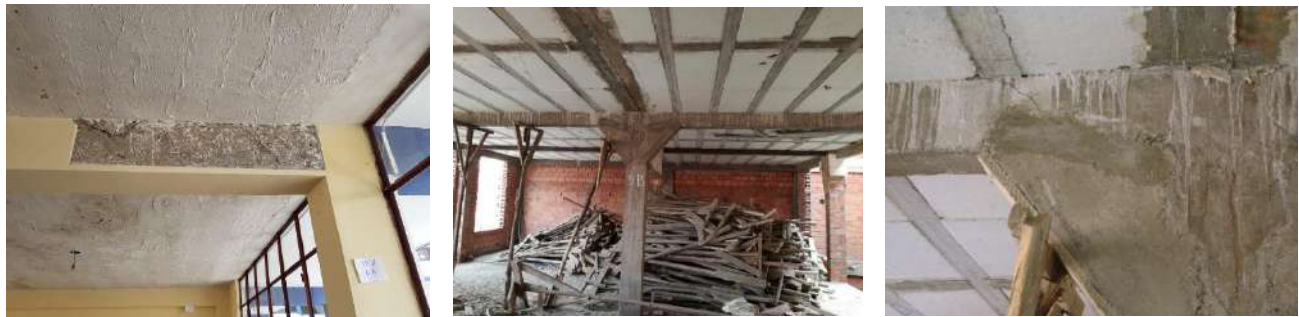
Figura 6. Aparición de fisuras en vigas y desprendimiento del hormigón
