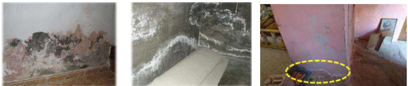
Figura 5. Aparición de eflorescencias superficial en elementos estructurales
