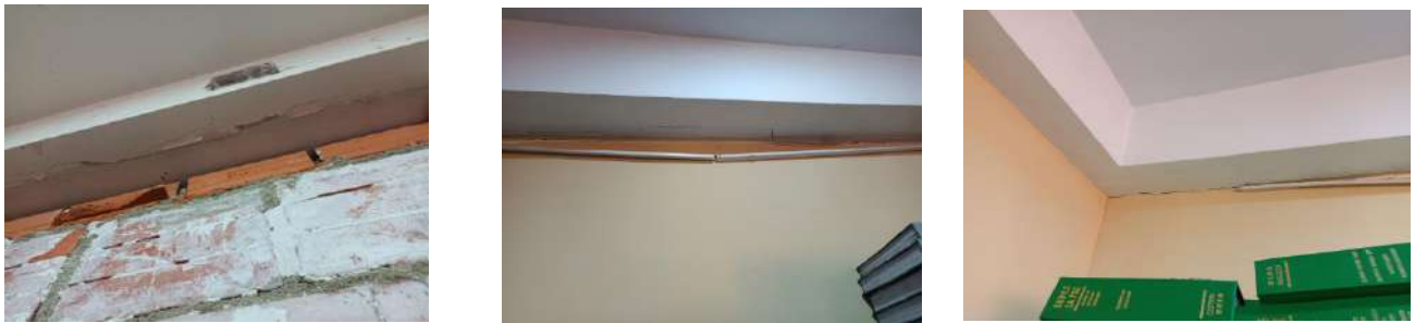
Figura 4. Asentamiento diferencial por exceso de carga
